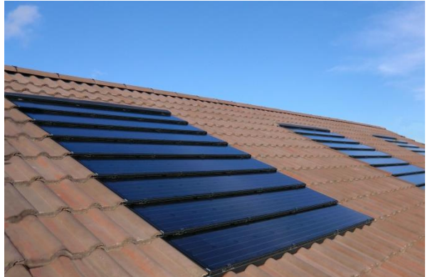
Zonnepanelen verwerkt in het dakvlak van een woning
