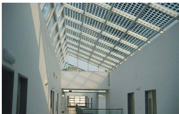
Zonnepanelen verwerkt in glazen dak
