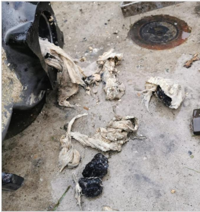
Figuur 3 verstopping pomp door doekjes en bouwafval
