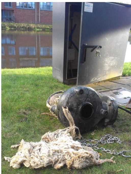
iguur 7-1 Een voorbeeld rioolgebruik, doekje in het riool leidt regelmatig tot pompstoringen.
